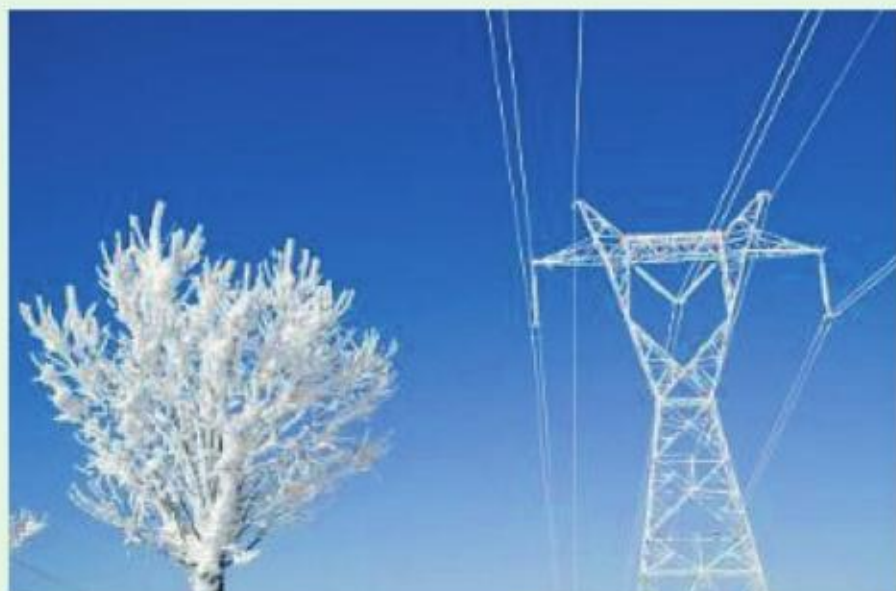
图2-10 被冰雪覆盖的电线
