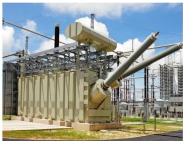
甲 变电站中的大型变压器
