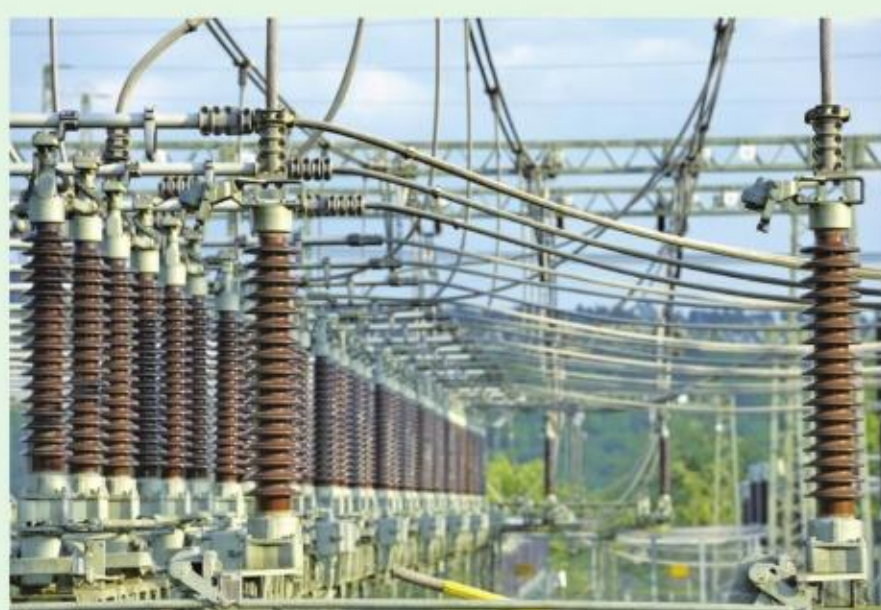
图1-7 变电站柱式绝缘子
