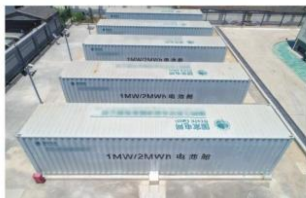
图4-5 锂离子电池储能电站
