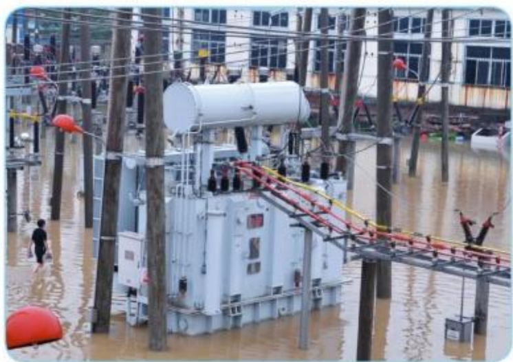
图 4.1.1 电力设备被损坏
