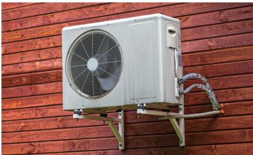
图1-7 空调的室外机支架
