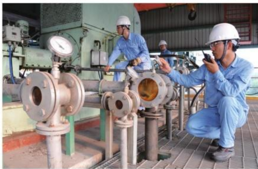
图 5-8 化工工程师通过观察仪表参数监控 化工生产过程
