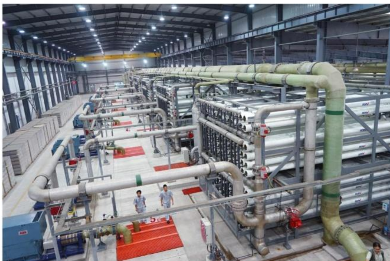
图 3.14 河北唐山曹妃甸的海水淡化车间
