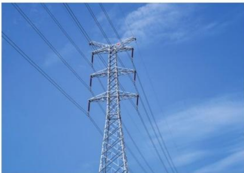
图19.1-8 高压输电铁塔上面有防雷导线
