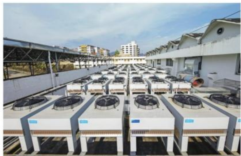
图18.4-7 大数据基地的散热设备
