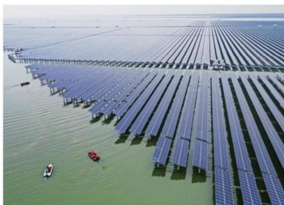
浙江温州滩涂光伏发电项目
