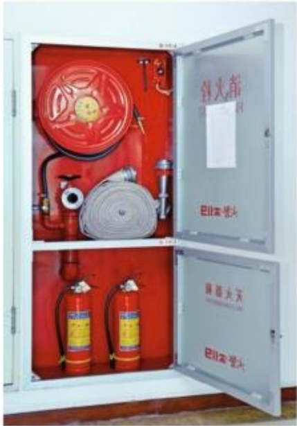
图7-8 建筑物内的消防设施
