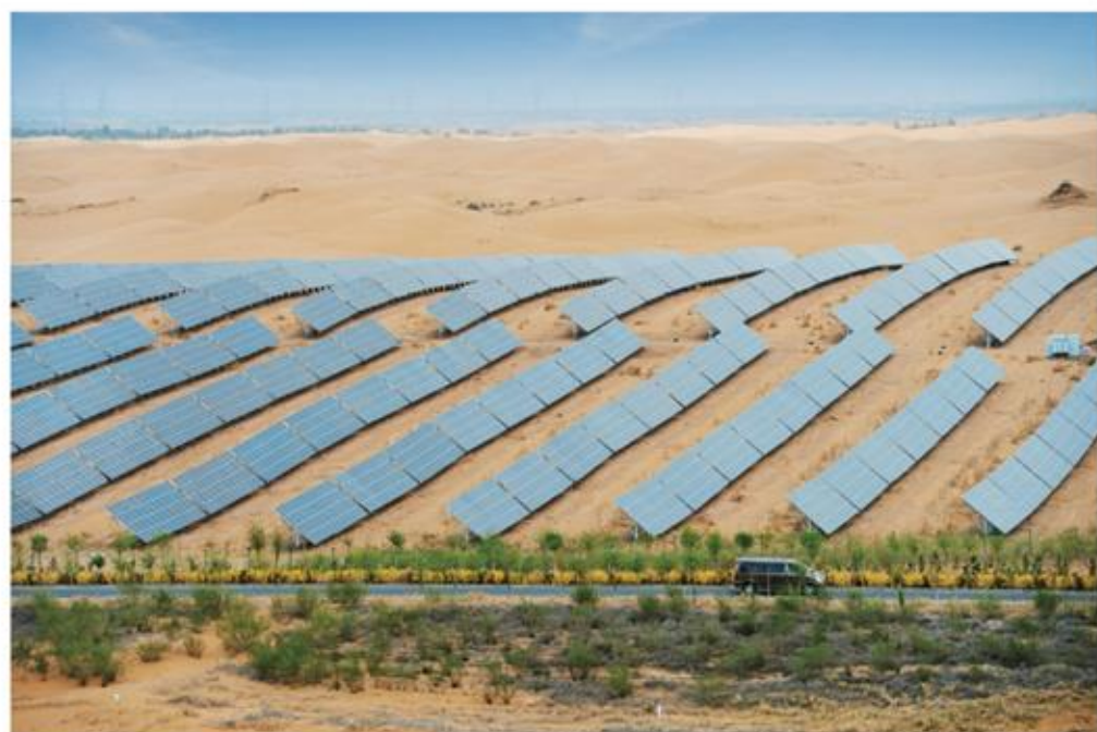
我国近年来建成的沙漠光伏电厂
