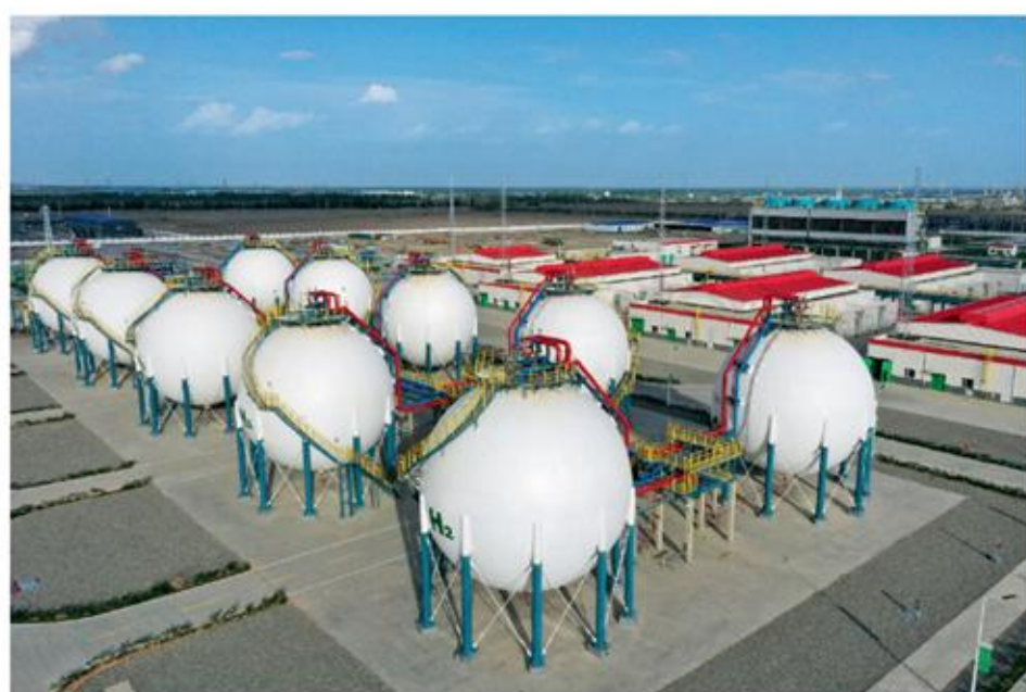
图11-9 我国建成的光伏电解水制氢工厂（图中为储氢罐和电解车间）
